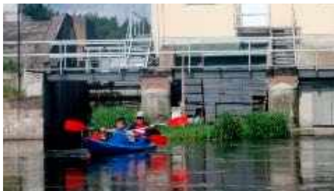
Rzeka Piława. Spływ do Nadarzyc. Elektrownia wodna (posadowiona na poniemieckim jazie fortecznym). Kajaki przenosiłmy lewym brzegiem ok. 60 m
